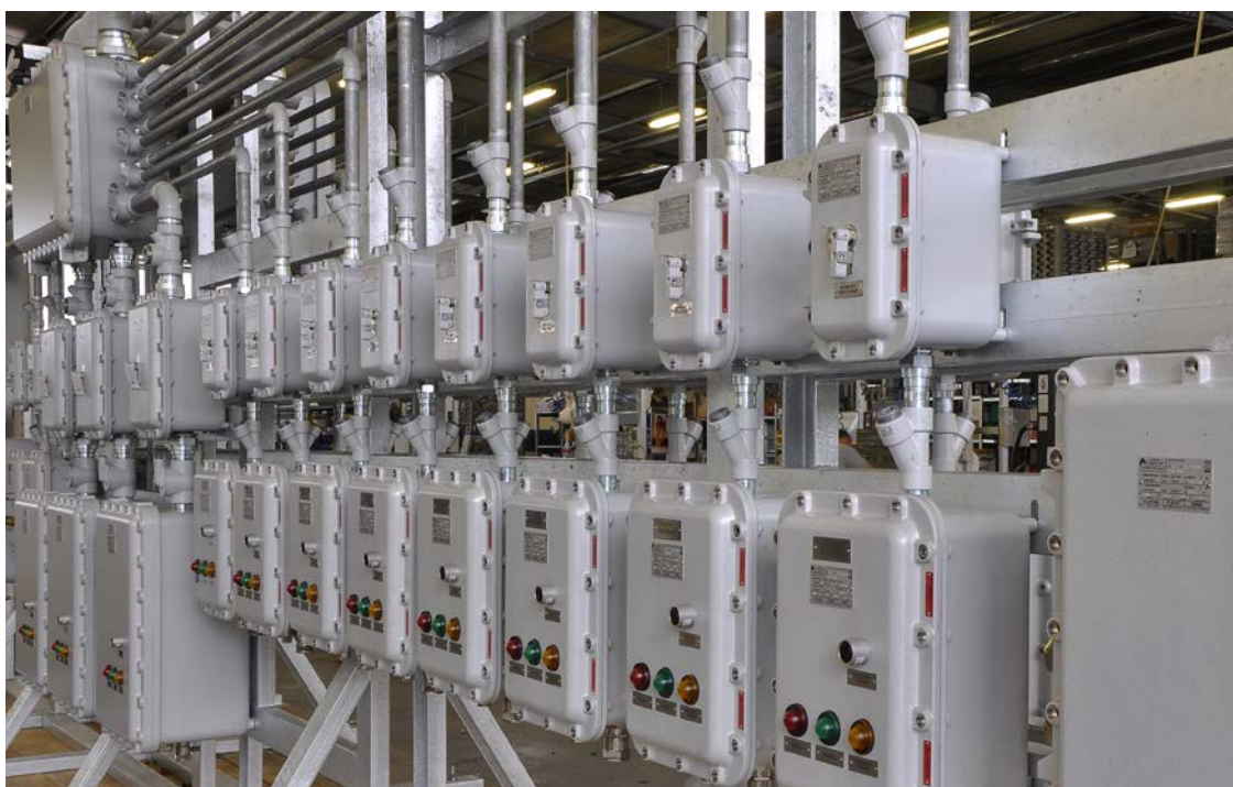
Fig. 16 Quadro di comando con installazione su doppio fronte realizzato su specifica del cliente
