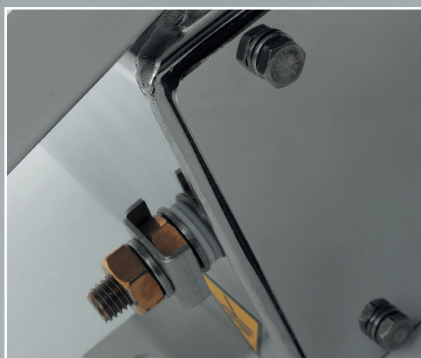
Bullone di messa a terra con staffa per l'antirotazione del cavo
